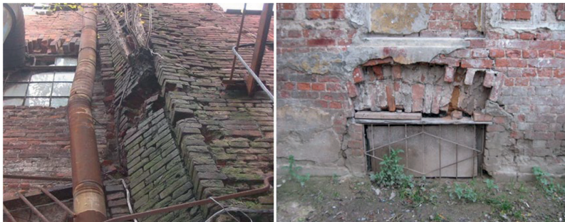
Рис. 5. Примеры значительного повреждения фасада с выпадением кирпича из кладки
