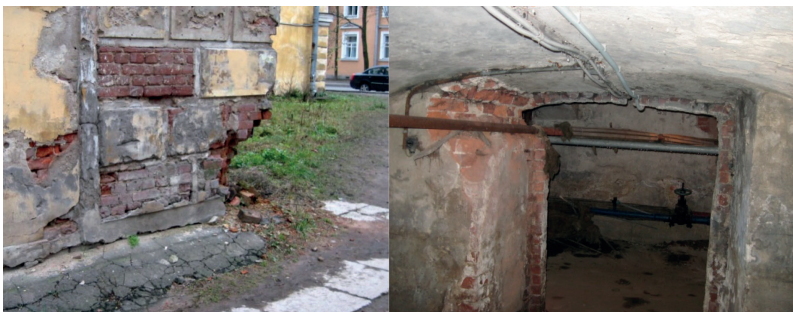
Рис 6. Разрушение кладки стены (слева) и механические повреждения опорной части кладки перемычки в месте пропуска труб (справа)
