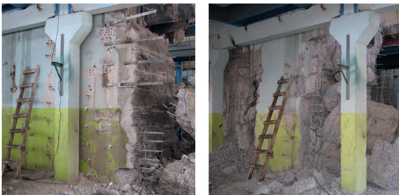
Рис. 3. Разрушение фундаментов под оборудование в литейном цехе завода «ЗИЛ» Смоленской области с сохранением несущего каркаса здания, выполненного из сборного железобетона [4]
