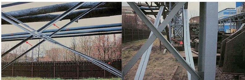
Рис. 3. Деформации элементов крестовых связей колонн крановой эстакады одного из машиностроительных предприятий Санкт-Петербурга
