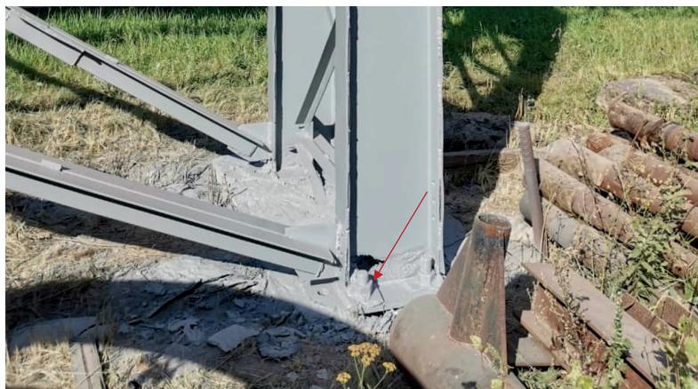
Рис. 2. Повреждения от коррозии на крановой эстакаде одного из машиностроительных предприятий Санкт-Петербурга
